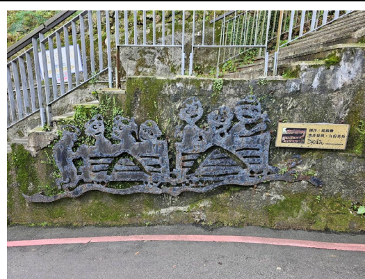
圖 9 九份耐侯鋼的腐蝕狀況
